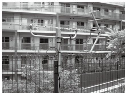
災害時用屋外アンテナ
