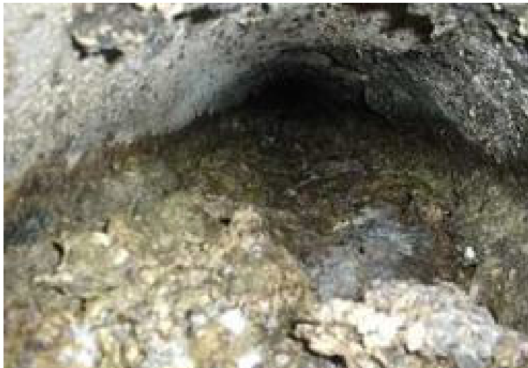
配管のつまり (油脂類)
