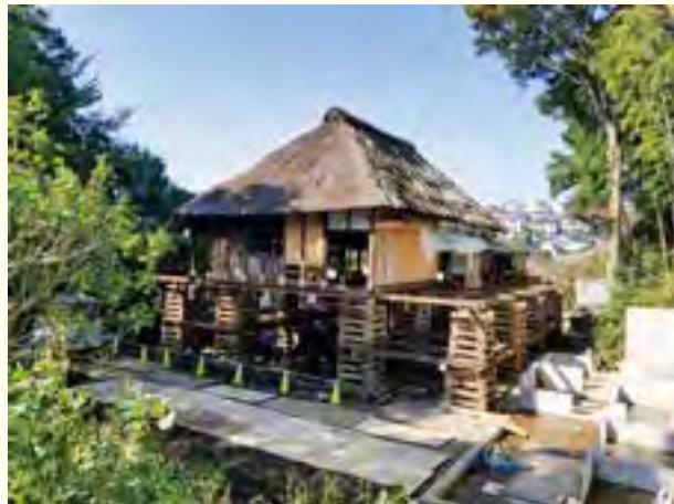
旧藤本家住宅主屋…横浜市認定歴史的建造物（平成 4 年（2002））、特定景観形成歴史的建造物（平成 28 年（2016））。建築基準法の適用除外により茅葺屋根の保全を図っている。写真は、復元に際しての揚屋工事。
