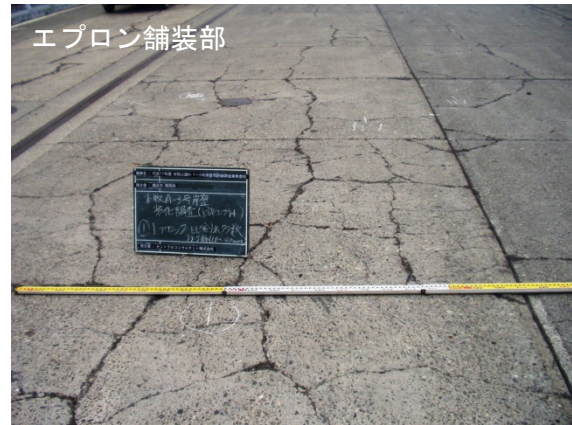
コンクリート舗装のひび割れ状況
