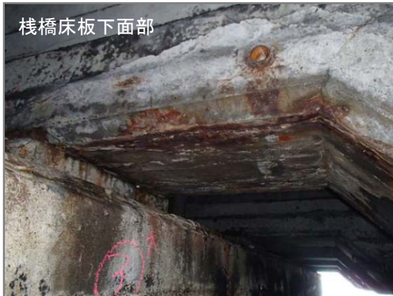
コンクリート梁の塩害状況
