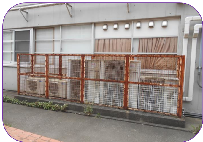
屋外機置き場全景① 左から和室、中研・小研・図書室の屋外機
