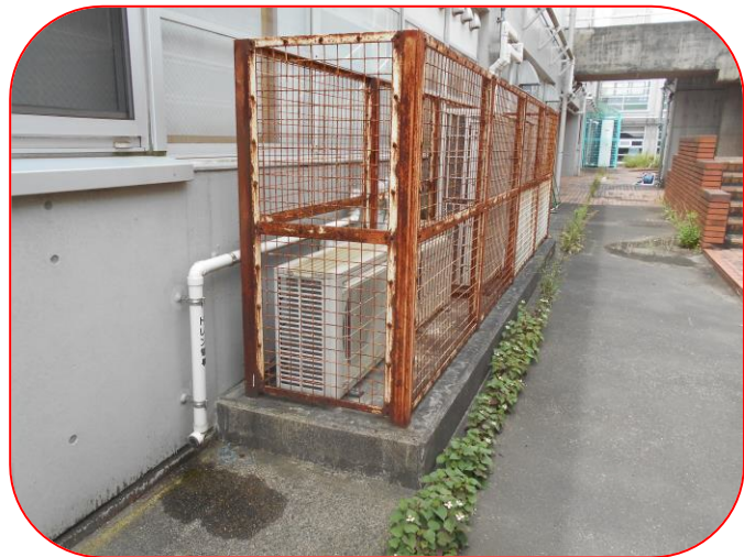
屋外機置き場全景③ 校庭側から中庭側を望む
