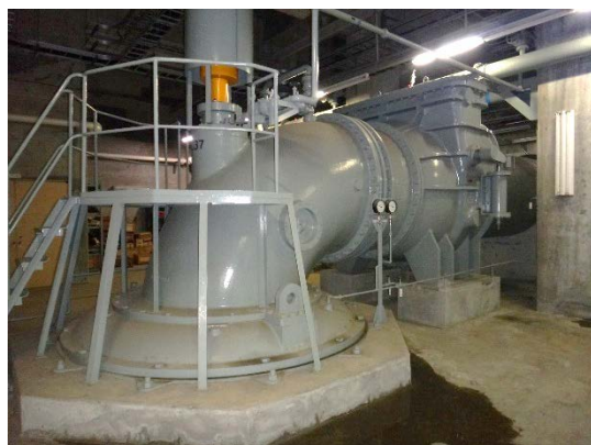
(雨水ポンプ口径 1800mm)
