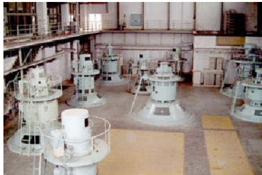
磯子ポンプ場内観
