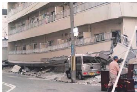
図表2-10-1 阪神・淡路大震災で崩壊したマンション
