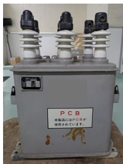
図表2-9-2 高濃度PCB廃棄物（コンデンサー）の例
