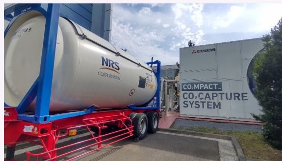
ごみ焼却工場におけるCO 2 回収実証
