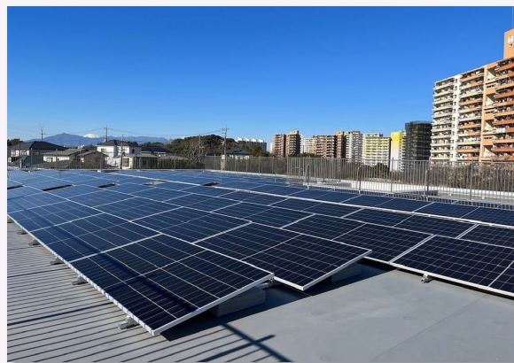
PPA事業で設置した太陽光発電設備 (市立学校)
