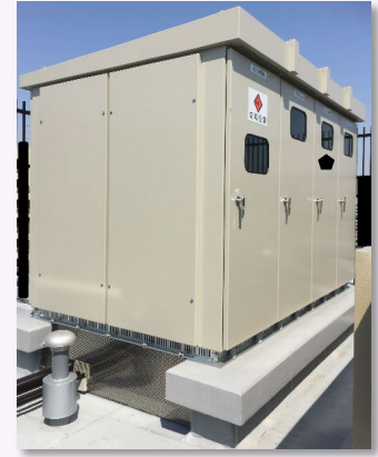
高圧一括受電の受変電設備
