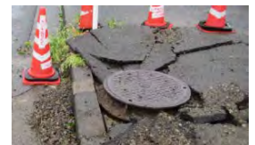
マンホール浮上被害状況
