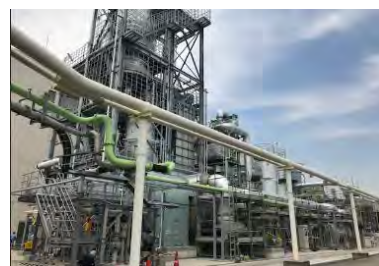
下水汚泥燃料化設備
