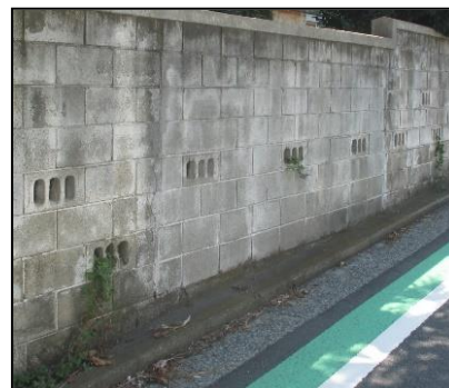
ブロック塀例
