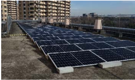
太陽光発電設備
