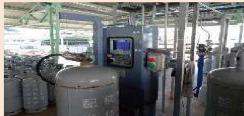
LPガスボンベ充填所 (出典：(一財)エルピーガス振興センター「LPガスガイド(H29年3月発行)」)
