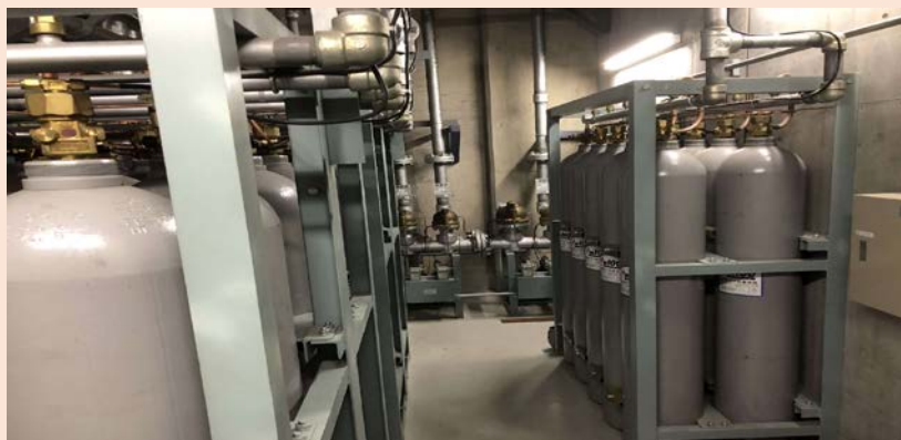
容器置場 (出典：川崎市消防局)
