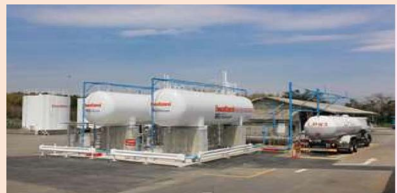
貯槽 (出典：同上)
