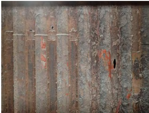
焼却工場 穴の開いたボイラ水管
