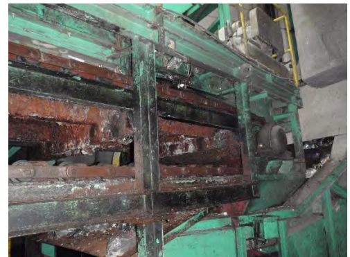
資源化施設 老朽化したコンベヤ
