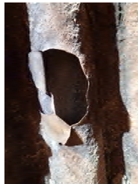
ボイラ水管穴あき詳細
