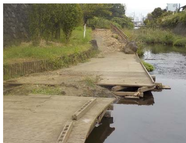
【親水施設(木製デッキ)の破損状況】
