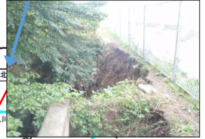
鉄道脇の河岸崩落 （JR東海道線、横須賀線）
