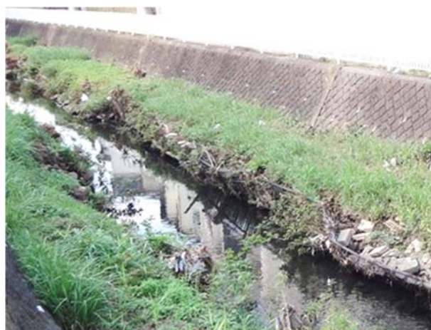
【低水路(木杭・矢板)の損傷状況】
