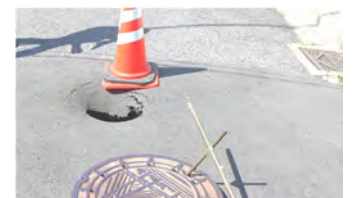
取付管破損による道路陥没
