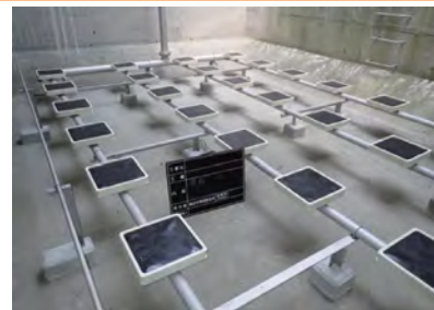
最新の散気設備
