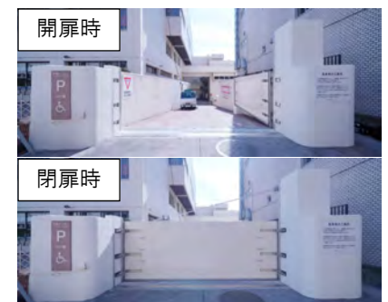
大型スイング式止水扉(戸塚ポンプ場)
