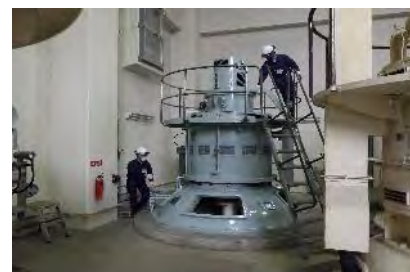
ポンプ設備の維持管理
