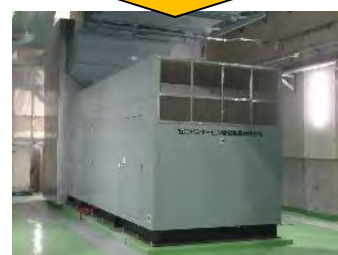
発電設備の更新
