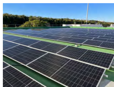
令和6年度導入太陽光発電設備 (金沢水再生センター)
