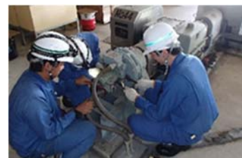
水処理設備の維持管理
