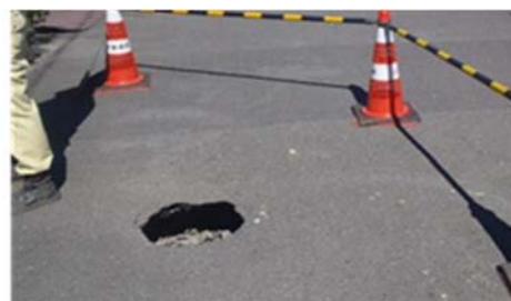
Zパイプ破損による道路陥没
