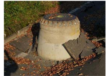
地盤の液状化によるマンホール浮上 (中越地震 新潟県川口町)
