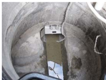
水位周知下水道マンホール蓋
