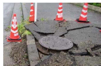
マンホール浮上被害状況
