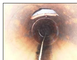
破損した下水道管内写真
