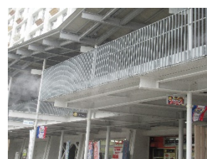
商店街に設置されたミスト装置 (令和元年度実施)
