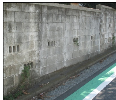
ブロック塀例
