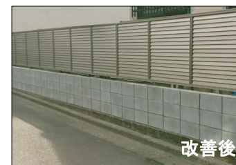
ブロック塀等の改善
