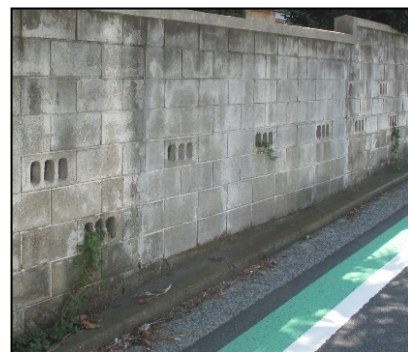
ブロック塀例
