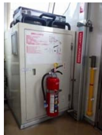
運転台継電器盤設置場所
