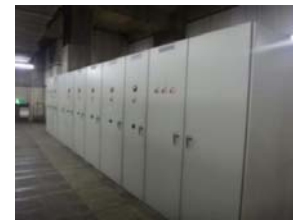
直流き電設備
