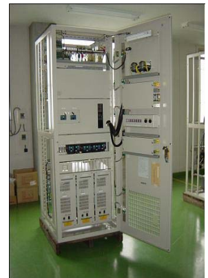
【参考】直流電源装置
