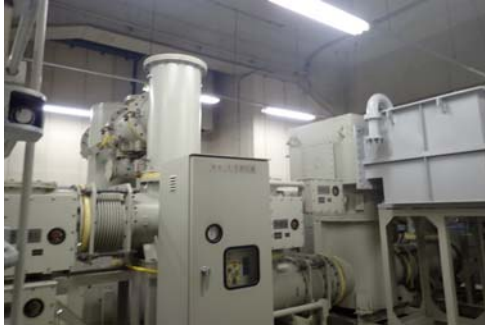
66kV 特別高圧受電設備
