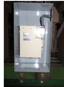
運転状況記録装置
