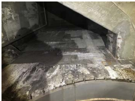
▲通風孔の劣化状況
