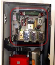
運転台継電器盤(設置状態)
