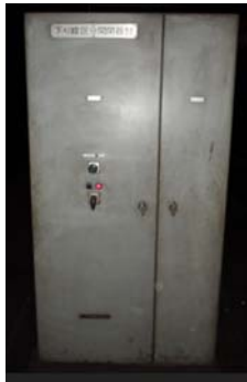
開閉器盤外観
