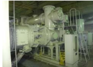
66kV 特別高圧受電設備
