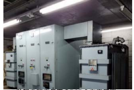
弘明寺駅電気室のPCB含有変圧器
