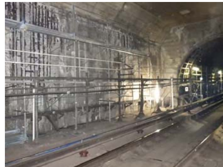
▲下り線の劣化状況
