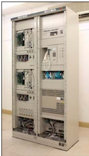
列車無線基地局装置
