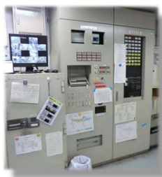
■自動火災報知設備、防犯モニター、非常放送
