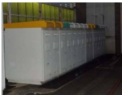
▼直流開閉器盤(C盤)
