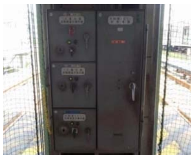
▼現地操作盤(G盤)
