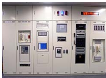
■自動火災報知設備ほか集約された防災設備
