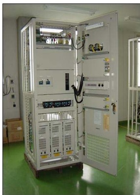
【参考】直流電源装置
