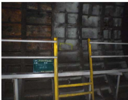
← ダクタイト セグメント 劣化状況
