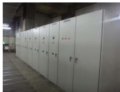
直流き電設備
