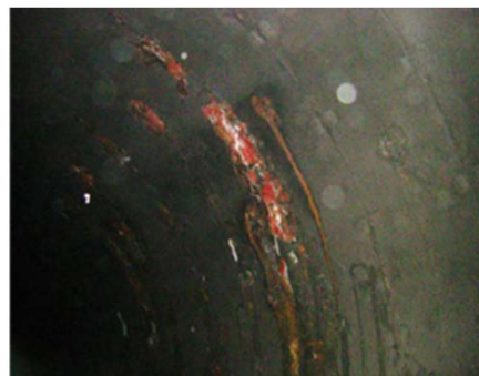
← 合成セグメント 劣化状況
