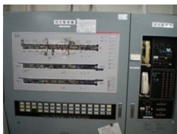
■自動火災報知設備
