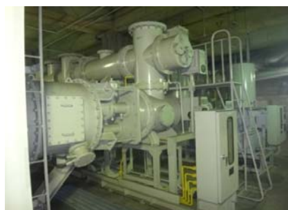
66kV 特別高圧受電設備
