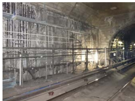
▲下り線の劣化状況
