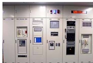
■自動火災報知設備ほか集約された防災設備
