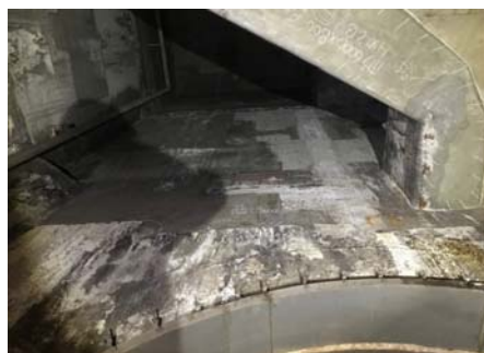
▲通風孔の劣化状況
