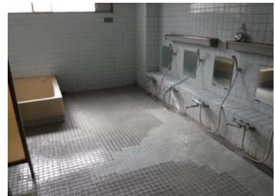
浴室 老朽化状況
