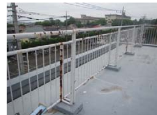
屋上手摺腐食・防水層不具合
