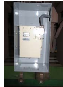
運転状況記録装置
