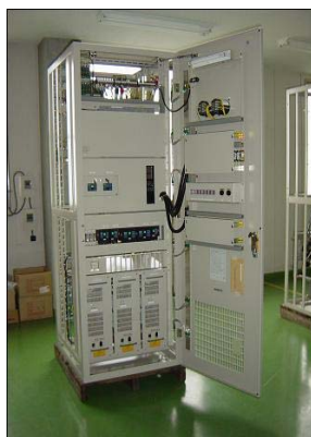
【参考】直流電源装置
