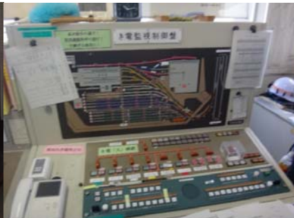
▼き電監視制御盤
