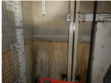
EVシャフト内漏水状況
