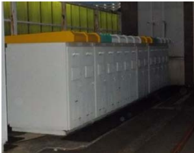
▼直流開閉器盤(C盤)
