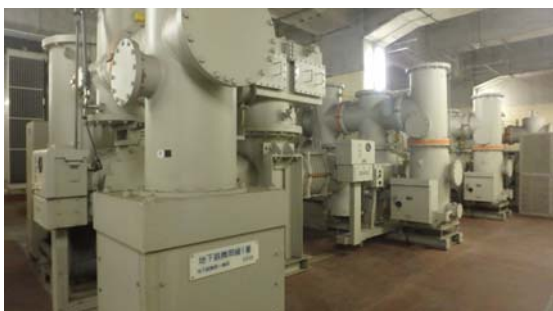
66kV 特別高圧受電設備
