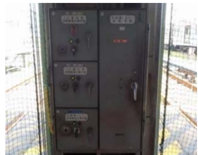
▼現地操作盤(G盤)
