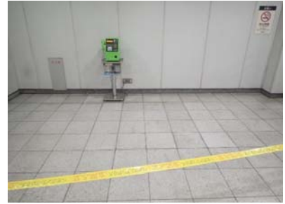
ラチ内コンコース湧水状況
