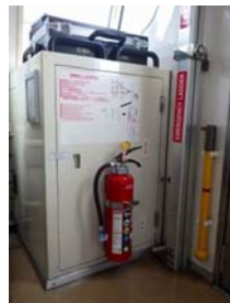
運転台継電器盤設置場所
