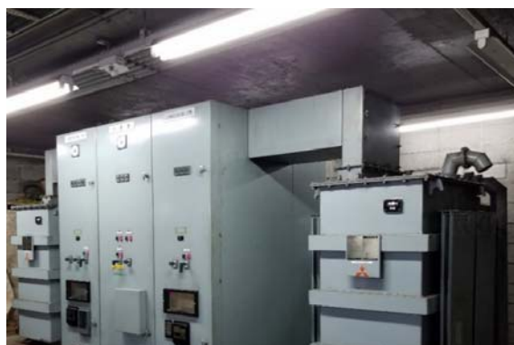
弘明寺駅電気室のPCB含有変圧器
