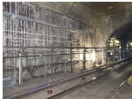
▲下り線の劣化状況
