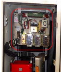
運転台継電器盤(設置状態)
