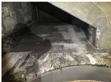
▲通風孔の劣化状況
