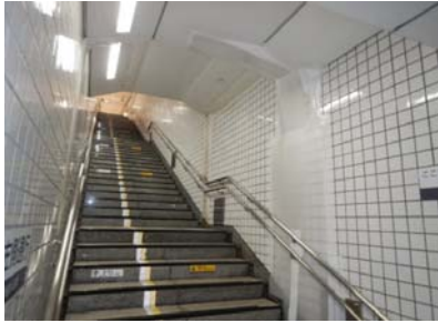
ホーム連絡階段漏水状況
