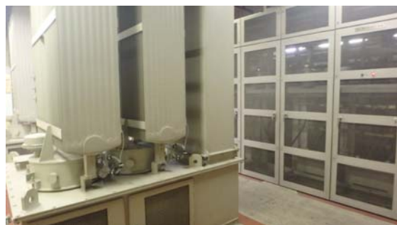
22kV/595V変圧器及び整流器
