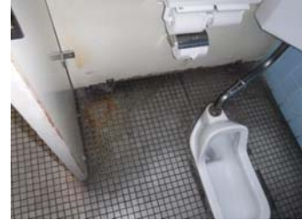
手洗所 老朽化状況
