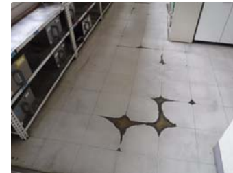
事務室前廊下仕上不良
