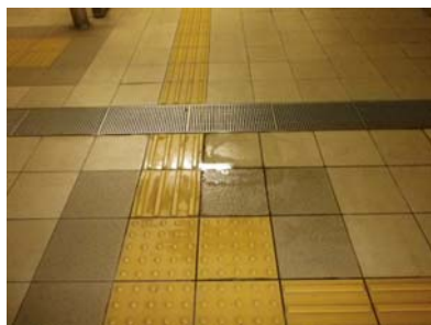
北山田駅 床湧水状況
