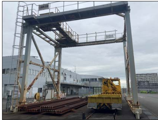
▲川和車両基地 門型クレーン
