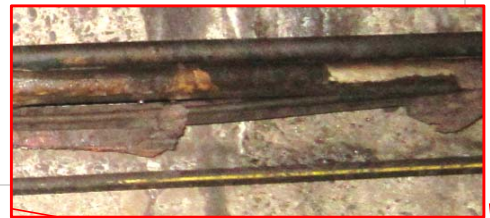
電らん棚腐食による撤
