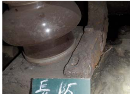
腐食した腕金及び短枕
