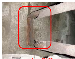
アンカー脱落
