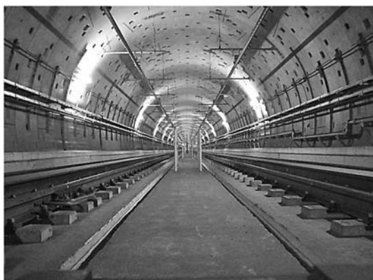
<トンネル照明>
