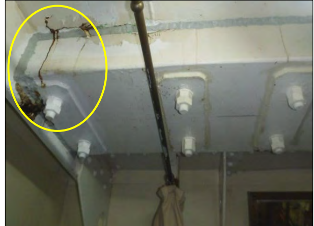
【凹甲板左舷ボラード下部漏水部分（丸部分）】
