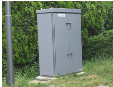
水道計測設備
