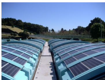
太陽光発電（小雀浄水場）
