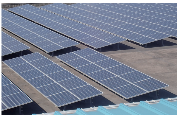
太陽光発電設備(川井浄水場)
