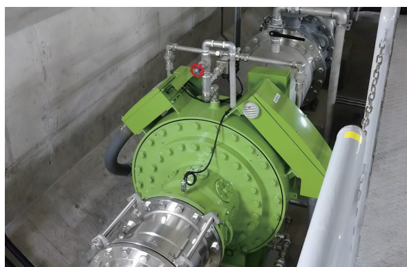
小水力発電設備(今井配水池)
