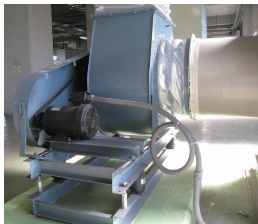
高効率モータ使用機器(送排風機)
