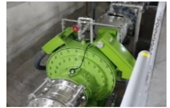
小水力発電設備
