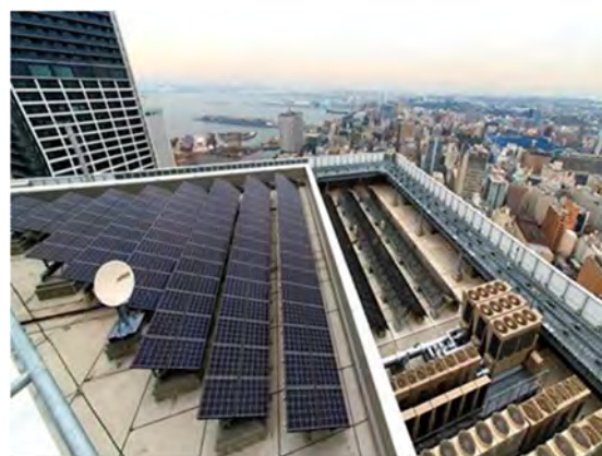
太陽光パネル
