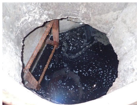
図2 ビルピット内の様子
