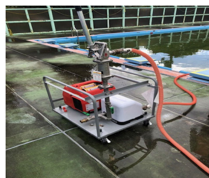
下水道直結式トイレに使用する プールの水を組むポンプ
