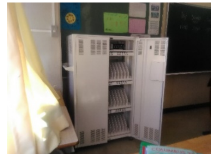
< 電源キャビネット >
