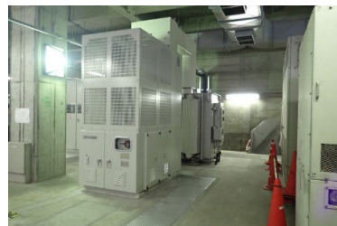
変電所機器・変圧整流設備
