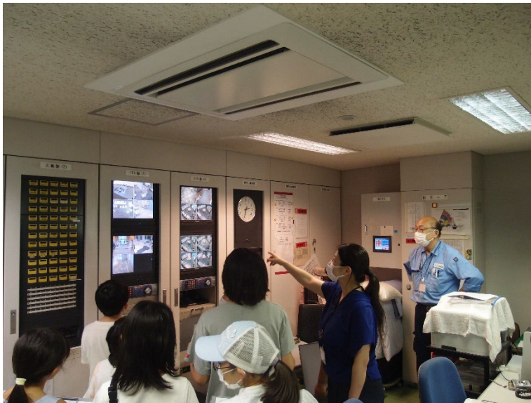
中央監視室で監視カメラや 温湿度調整の装置を見学
