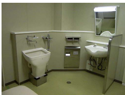
左：汚物流し 右：腹部洗浄台
