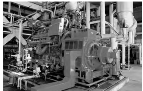
図1-8 北部汚泥資源化センター消化ガス発電
