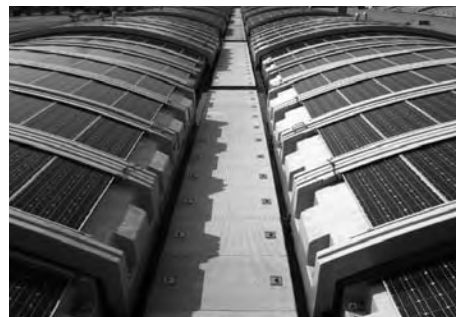
図1-6 ろ過池などに設置した覆蓋(ふた)の上部の太陽光発電装置
