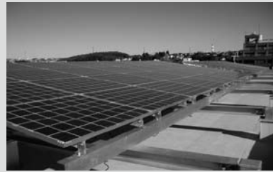
川和車両基地の太陽光発電装置
