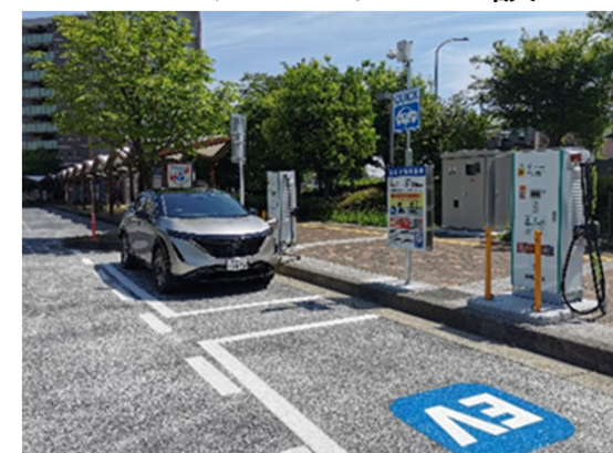
センター南駅広場において、 公道上にEV用充電器を設置
