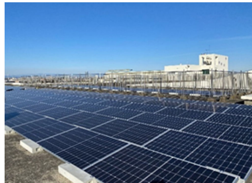
PPAを活用した 学校への太陽光発電設備の設置
