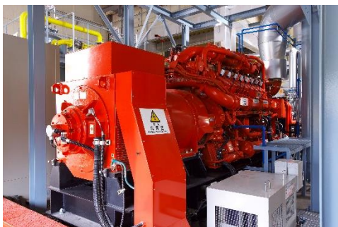
図 1-11 消化ガス発電機
