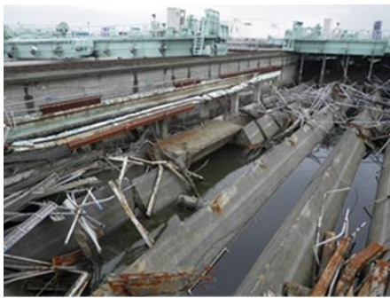
津波により破壊された水処理施設 (東日本大震災)
