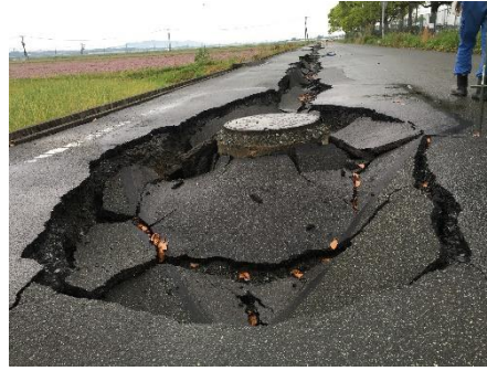
地震による下水道管上部の道路陥没 (熊本地震)
