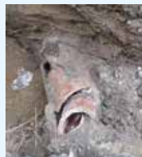
老朽化により破損した下水道管
