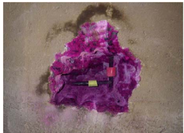
写真-3 鉄筋腐食状況確認
