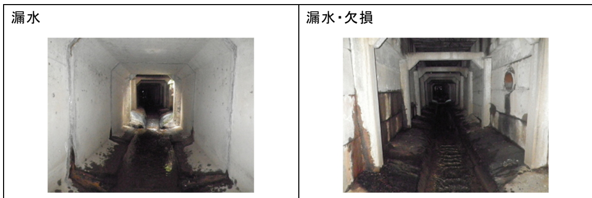
図 2-4 暗きよの変状例
