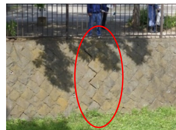
護岸のひび割れ
