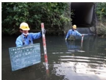
河道内の洗掘
