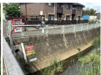
水防機器の管理
