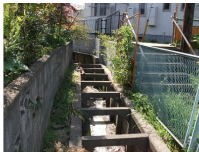
水路 (緑区 柵きょ形式の水路)
