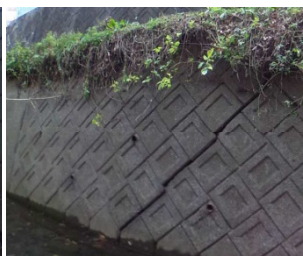
護岸ひび割れ・はらみだし
