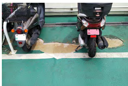
屋上防水の破損
