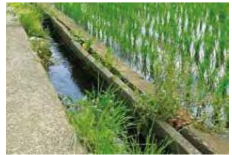
老朽化した用水路
