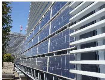
太陽光パネル
